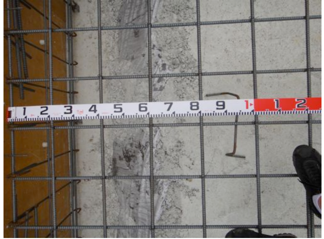
【耐圧盤(基礎の床)配筋の確認】 耐圧盤(基礎の床)の配筋の確認です。縦・横とも200mm間隔で、太さはD13mmで図面通りです。(写真はX方向の確認です。)また、下部捨てコンクリートと、60mm以上鉄筋が浮いていない箇所が一部ありましたので、寸法を確保します。
